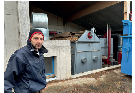
↑ Patrick Meier montre la centrale de cogénération de l'entreprise, à gazéification du bois.
